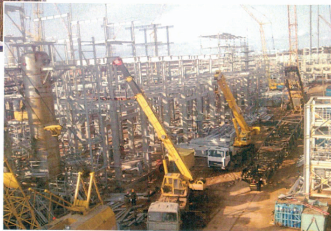
Комплекс гидрокрекинга (Киришинефтеоргсинтез, Ленинградская область)
